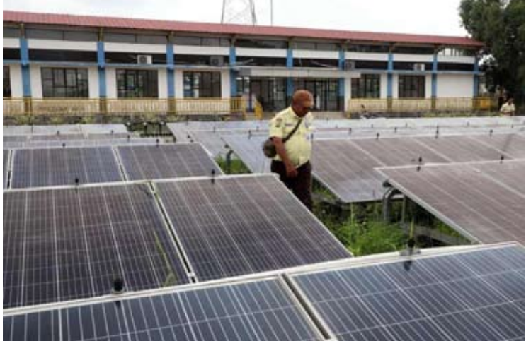
太阳能发电厂 (PLTS)。
