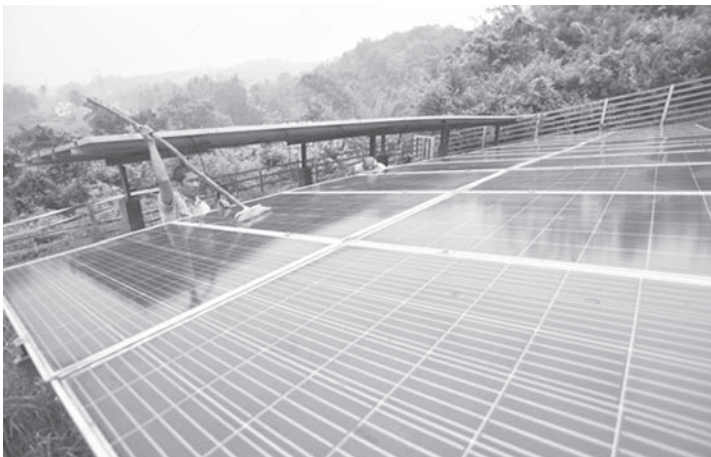
9月12日，工作人员在印尼西苏门答腊省沙哇伦多市塔拉维穆迪亚克村清洁灌溉用太阳能发电设施的光伏板。
